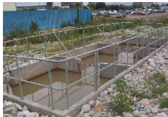
廢水收集設施
