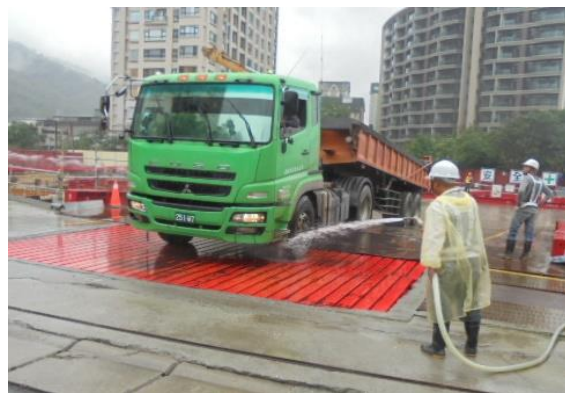
加壓沖洗設備
