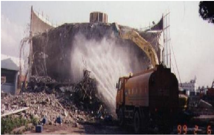
設置加壓噴灑水設施
